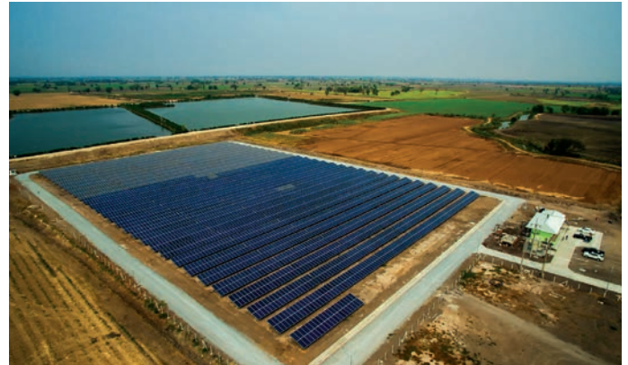
การผลิตแสงอาทิตย์แบบติดตั้งบนพื้นดิน อ.ด่านช้าง จ.สุพรรณบุรี
