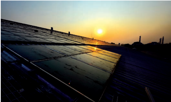
โครงการโซลาร์ รูฟท็อป บนหลังคาของโรงเอทานอล อ.ภูเขียว จ.ชัยภูมิ
